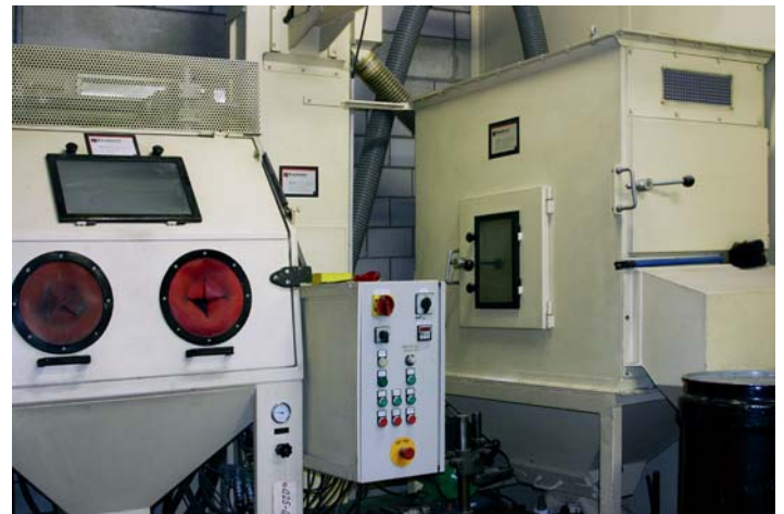
Kabine 3: Installationen ausschließlich für den Medizinalbereich. Booth 3: installations used exclusively in the medical sector.
